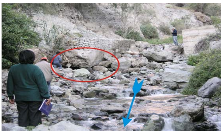
Foto N° 11.- Estado de los canales de los agricultores del valle de Curibaya antes del mantenimiento
